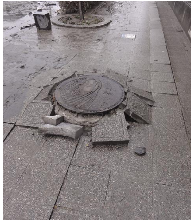
隆起しているマンホール。津波が下水道に入り込み、マンホールを押し上げた
