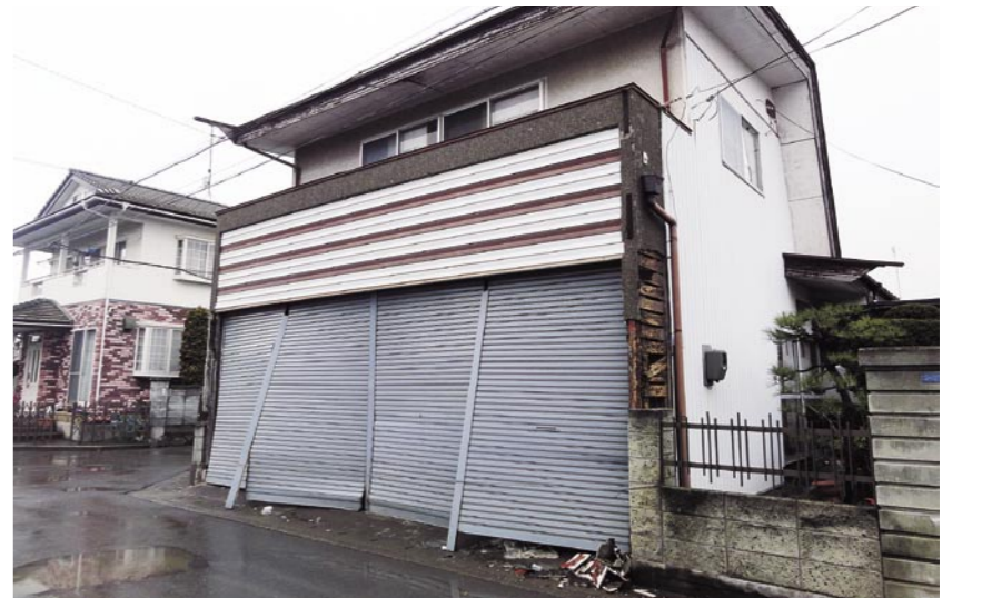
1階南面のシャッター部分が外れて、前方にはじき出されている住宅
