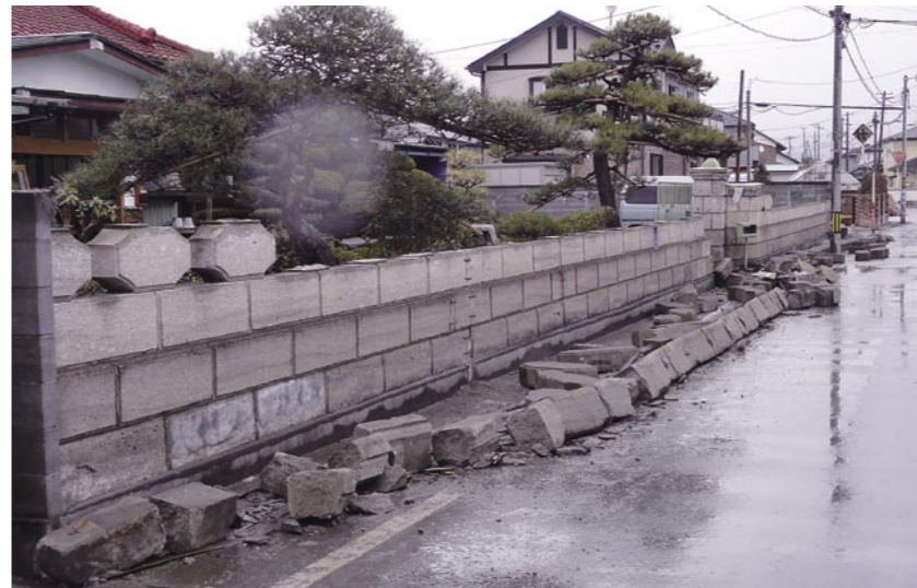
塀の上部がきれいに崩れ落ちている
