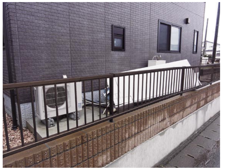
足元が壊れた屋外設置のヒートポンプ給湯機本体が倒れていた
