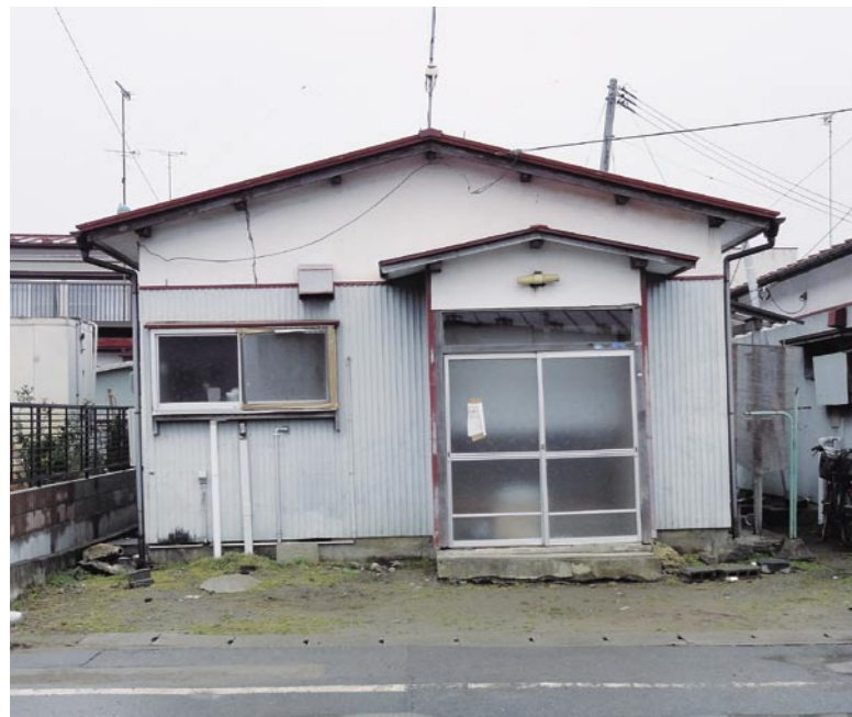
この古い家も左に大きく傾いている。玄関に応急危険度判定で「危険」の張り紙が見える
