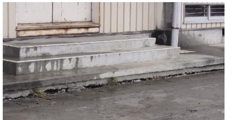
小学校の体育館。地盤沈下によって土間コンクリートと地面の間がパッキリ開いている
