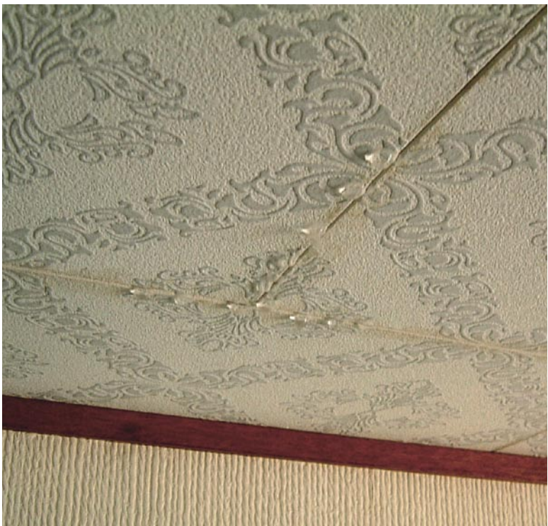
スガモリを起こして天井が濡れている住宅の例
