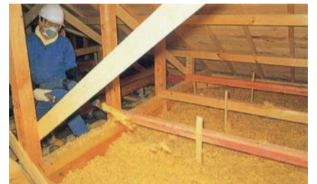
天井断熱では隙間なく断熱材を施工できるブローイング工法を採用する
