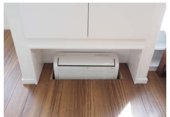
上下2方向吹き出しのエアコンを使い、室内と床下の両方を暖房している例。床面が温まることによって体感温度も高くなる
