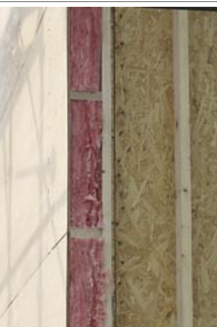
出隅にかかる一方の壁際に横棧を入れている現場。この現場では出隅の角に立てる間柱材を付加断熱のグラスウール充てん後に施工している
