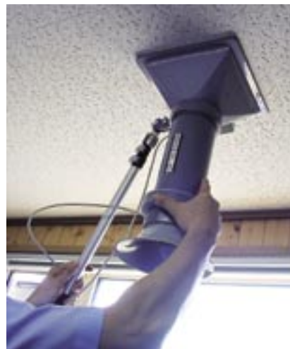
換気風量測定では換気口に測定装置を当てて空気の流量を測る。これにより各部屋の換気バランスの調整もしやすくなる
