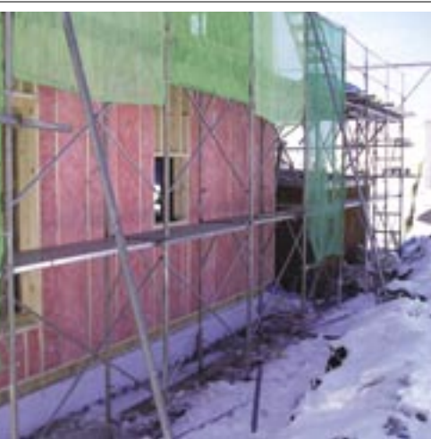
費用対効果の大きい旭川では今年もQ1.0住宅の建設が活発で、200mm断熱を推進している (写真は東光工務店の施工現場)
