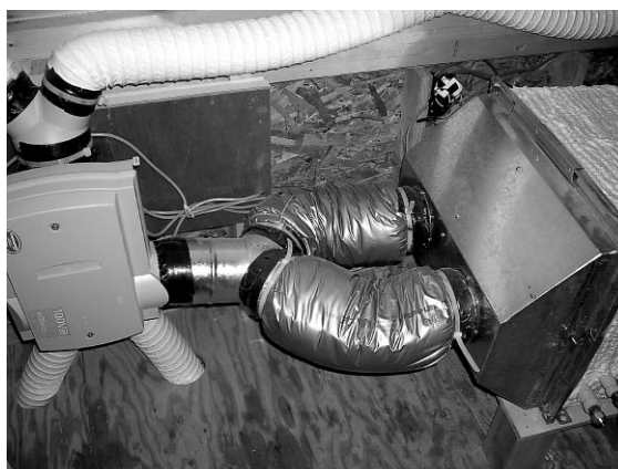
小屋裏に設置された第三種換気本体(左)とキーテック工業の改良型空気熱交器(右)。排気を2つに分けて空気抵抗を少なくし、効率的に廃熱を回収できるようになっている
