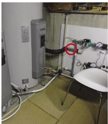
長土居さんの自宅では電気温水器の配管の継ぎ手から水漏れがあった(赤丸部分)。床に水が染みた跡が残っている
