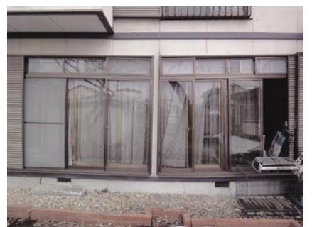
地盤が沈下してV字型に傾いた岩手県北上市の住宅(D・LIFE畠山社長提供)
